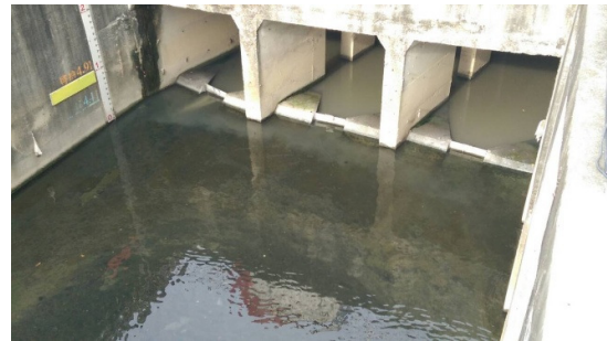
北港 4 後水門抽水站處理前後水質差異
