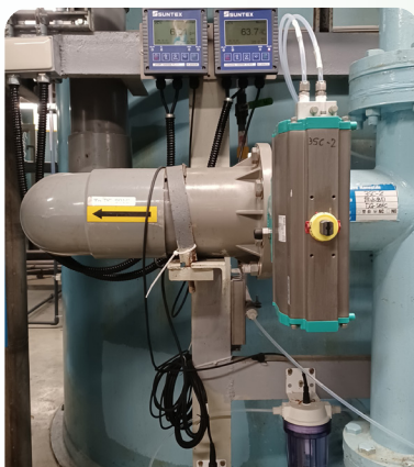
純水系統樹脂塔優化管控
