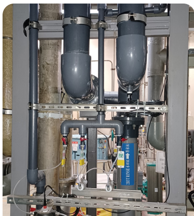
DI 樹脂塔再生 RINSE 水回收
