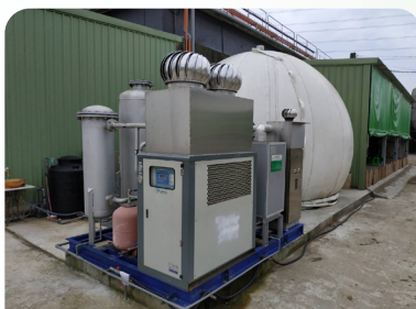
沼氣純化儲存設備
