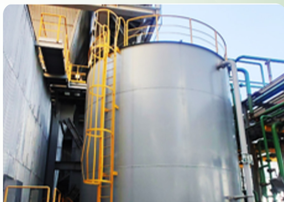
排煙脫硫系統補充水槽
