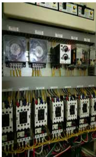
(b) 內部配電線路 狀態正常
