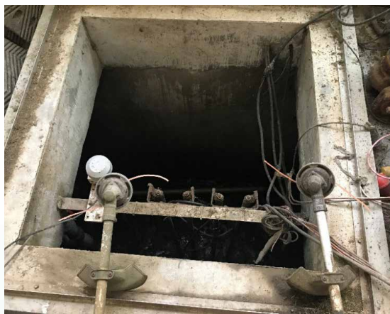
(b) 打開人孔蓋確認接觸曝氣槽液位
